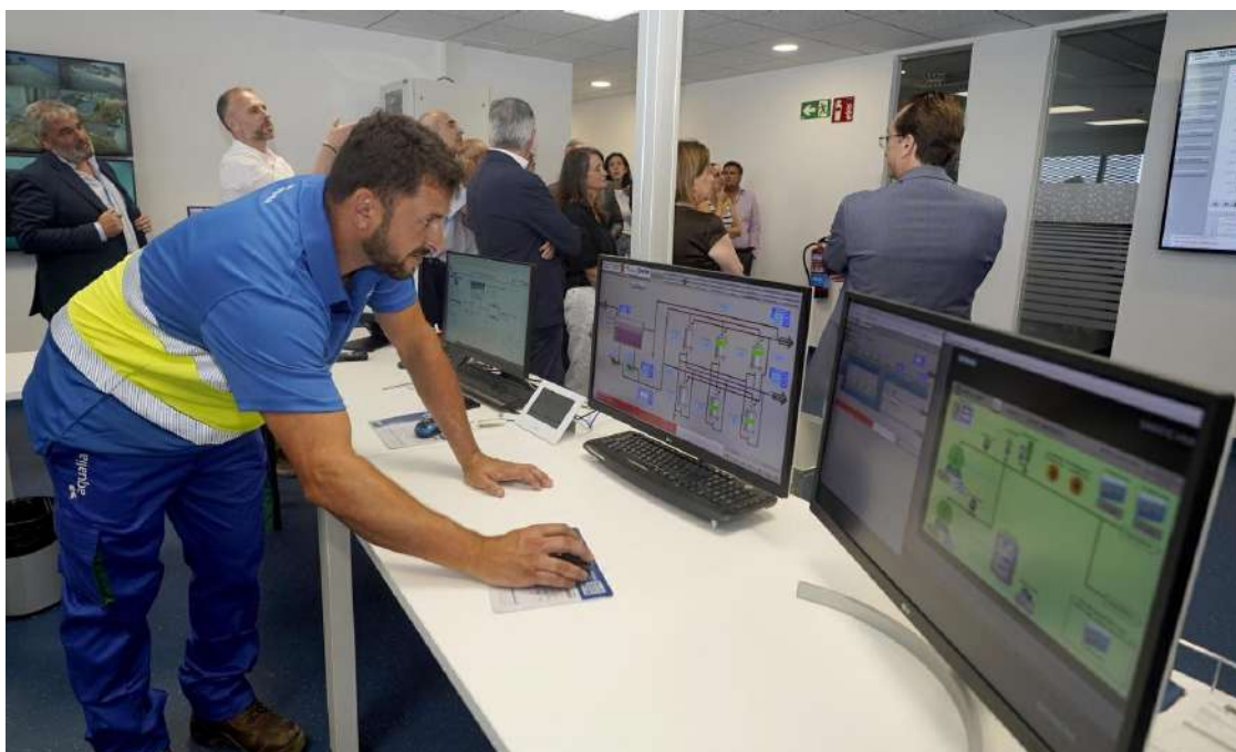
Un técnico de Aqualia en las instalaciones de la potabilizadora.
